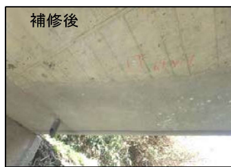
RC床版橋の鉄筋露出
