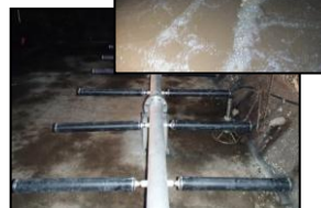
微細気泡散気装置の設置状況
