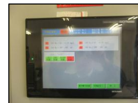
コントロールパネル(DO制御)
