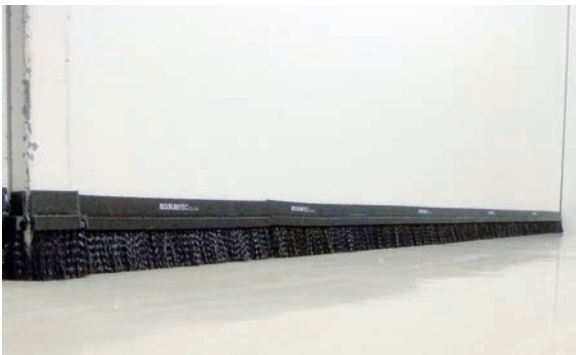
防虫ブラシ設置状況 (収蔵エリアへの扉下部)
