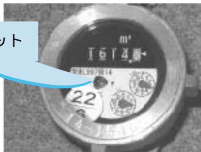
水道メーター
