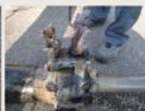
▲下水道設備に詰まった布
