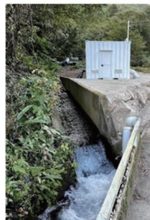
コンパクト小水力発電システムが設置されている吉野ヶ里町の「松隈小水力発電所」
