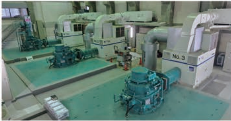
▲増強工事完了後の排水機場内部。ポンプが3台設置されています。
