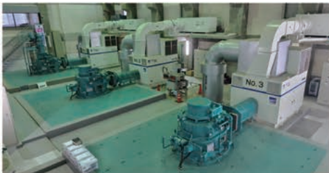
▲増強工事完了後の排水機場内部。ポンプが3台設置されています。
