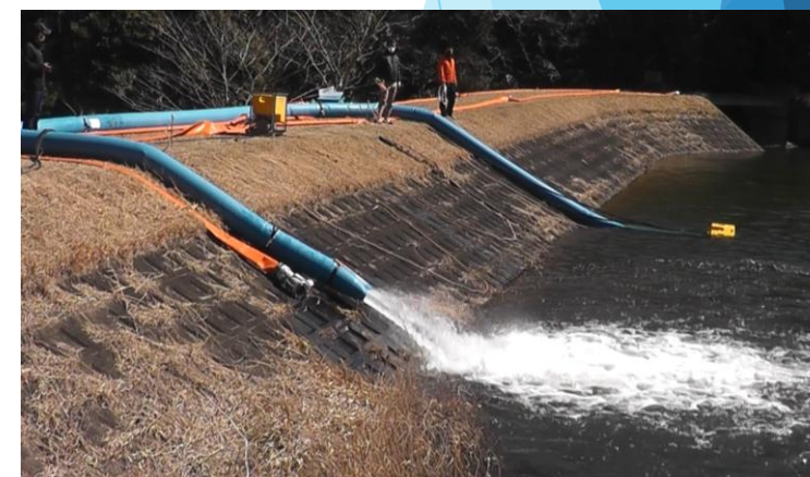
排水ポンプ展示 (武雄町 四十九重溜池 R4.2.24)
