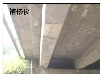
RCT桁のうき
