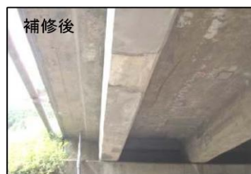
RCT桁のうき
