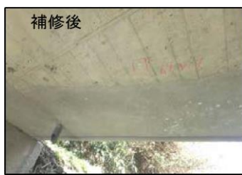
RC床版橋の鉄筋露出
