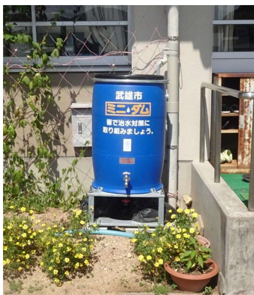
写真 3-2-2 雨水貯留タンク
