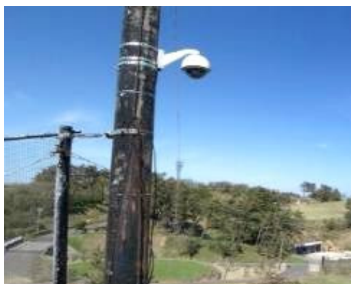
写真 3-2-3 内水監視カメラ
