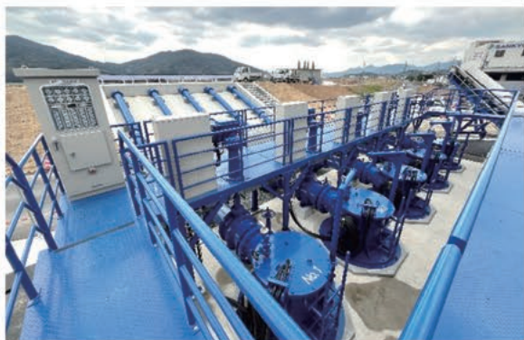
▲排水ポンプや操作盤が立ち並ぶ様子
