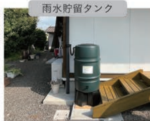
雨水貯留タンク
