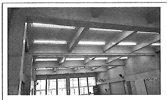
中学校 高効率照明器具(LED)導入
